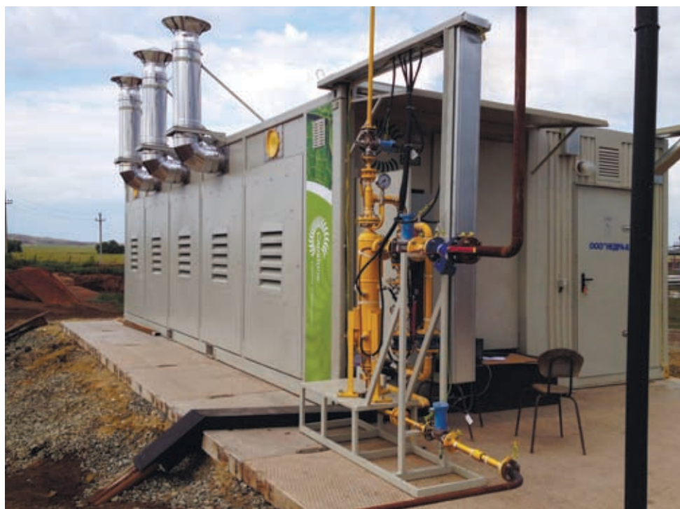
На фото: микротурбинная электростанция ENEX 600 на попутном нефтяном газе Боголюбовского нефтяного месторождения в Оренбургской области
