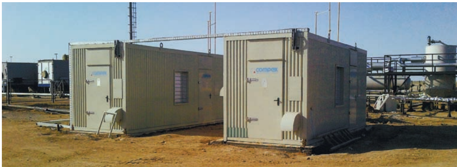
На фото: дожимные компрессорные станции COMPEX 110 на месторождении Сарыбулак, Республика Казахстан
