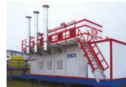
Микротурбинная электростанция ENEX на 600 кВт утилизирует попутный газ Сыповского нефтяного месторождения в Пермском крае
