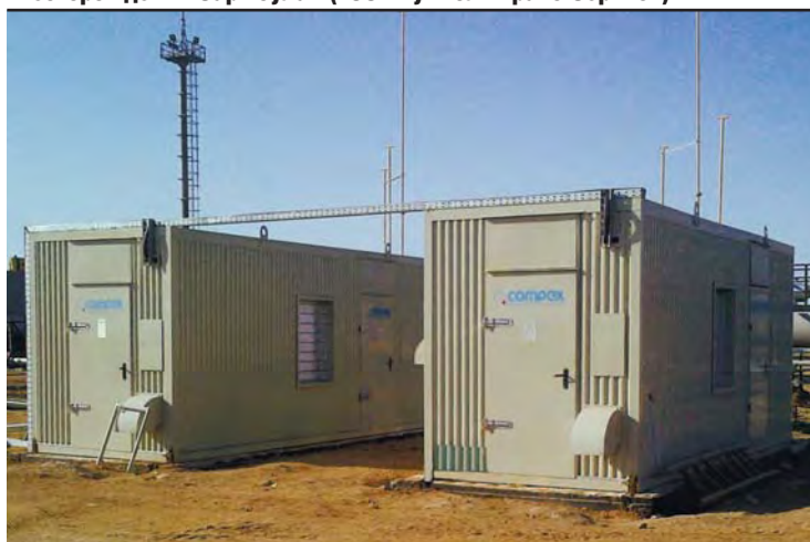
Рис. 8. Дожимные компрессорные станции COMPEX 110 на месторождении Сарыбулак (ТОО «Кумколь Транс Сервис»)
