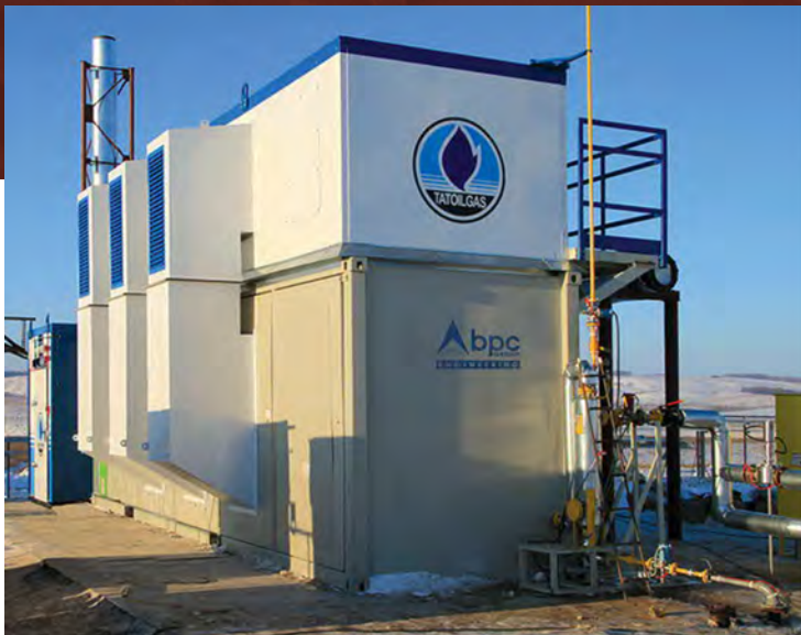
Рис. 5. Микротурбинный энергоцентр УПСВ «Шигаево» ОАО «Татнефтеотдача» (НК «Альянс»)
